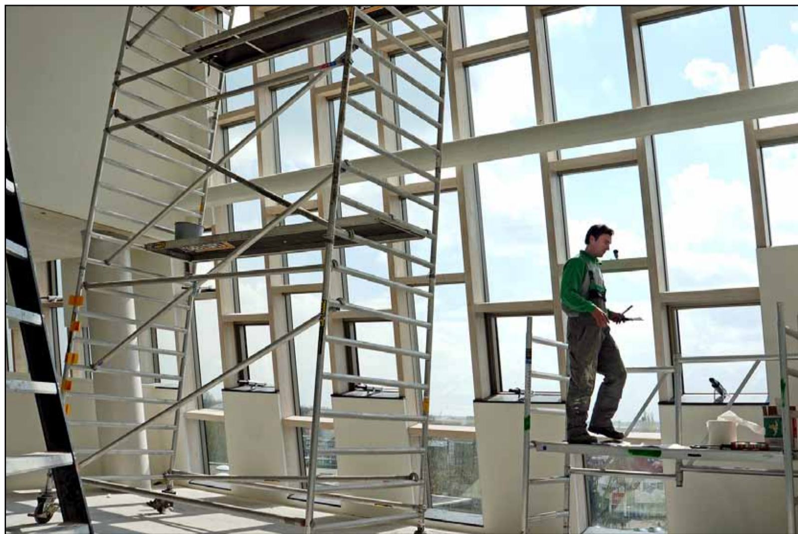
De timmerlieden, schilders en installateurs hebben nog zo'n 10 weken om alles gebruiksklaar te maken.
